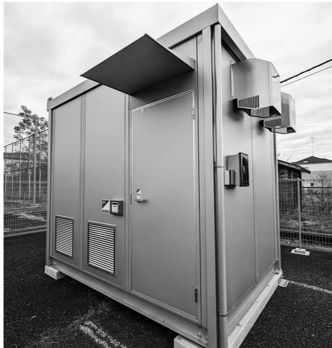
2024年に稼働を始めたマイクロデータセンター
