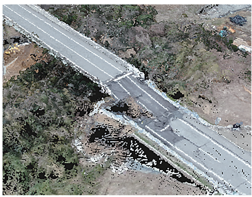
能登半島地震で被災した橋梁の点群データ画像(九州地方整備局提供)
