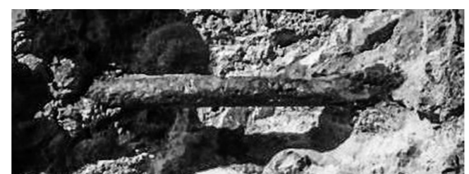
測定箇所の鉄筋状態
